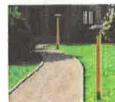
Stâlp de iluminat 2
