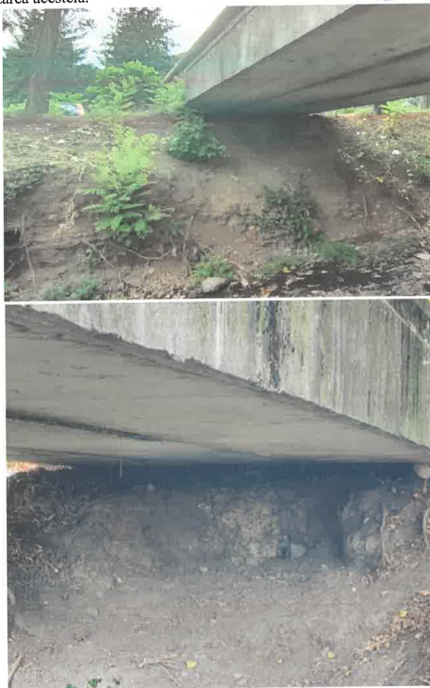
Vedere culee mal drept
