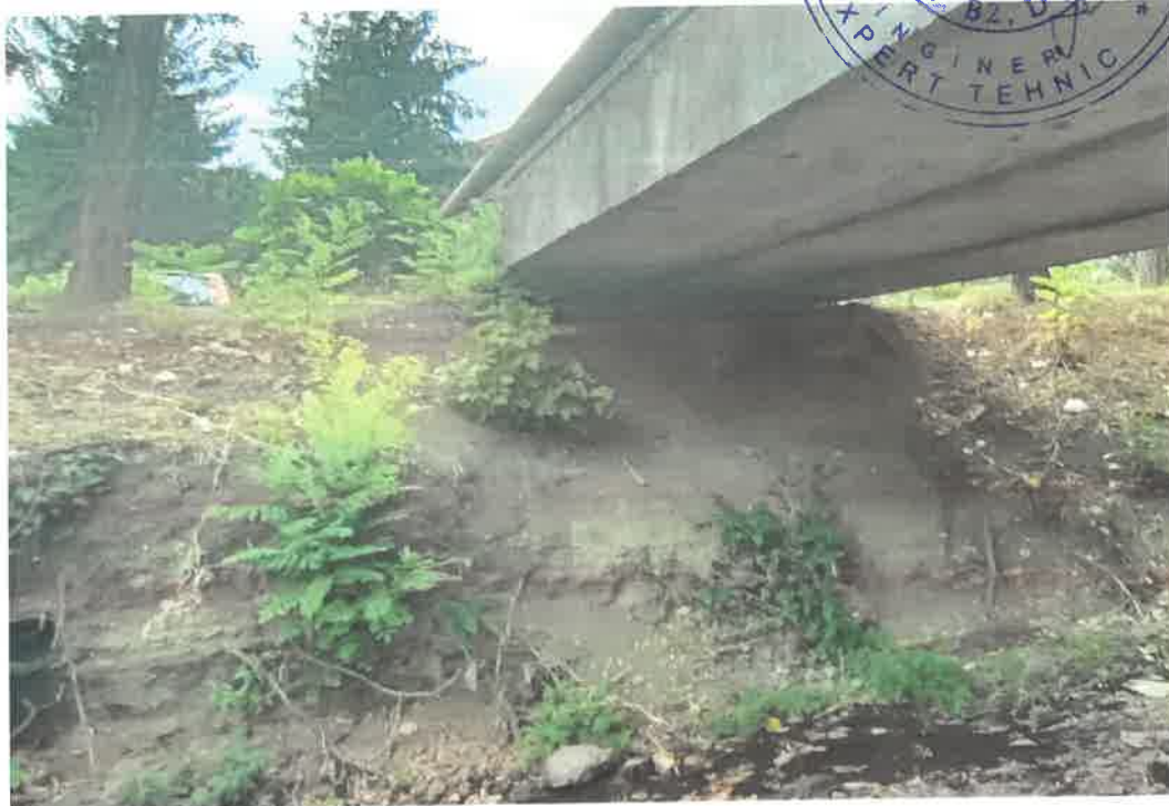
Vedere culee mal drept
