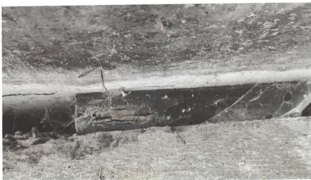
Foto 15: Degradari aparate de reazem
