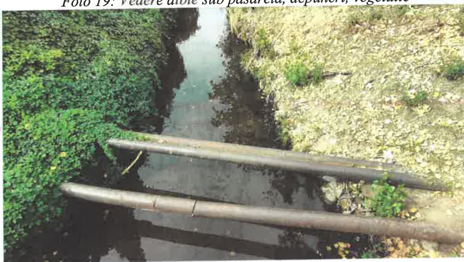
Foto 20: Vedere conducte utilitati in amonte de pasarela
